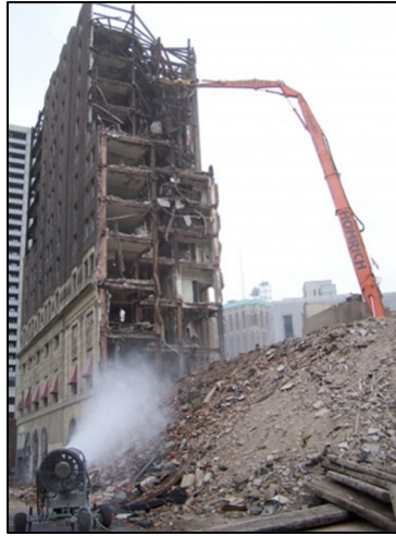
Şekil 2. Kentsel dönüşüm uygulamaları sonrası oluşan yıkıntı atıkları (Nilay Coşgun Arşivi)
